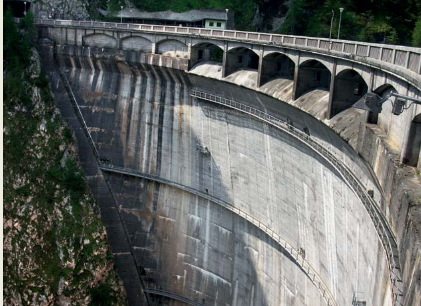
Jez na reki Lumiei je bil v času gradnje največji v Italiji in eden največjih v Evropi. Foto Janja Lipužič
