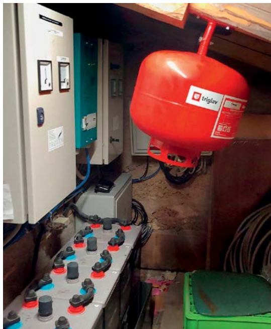
Avtomatski gasilnik Foto Stanislav Rožanc
