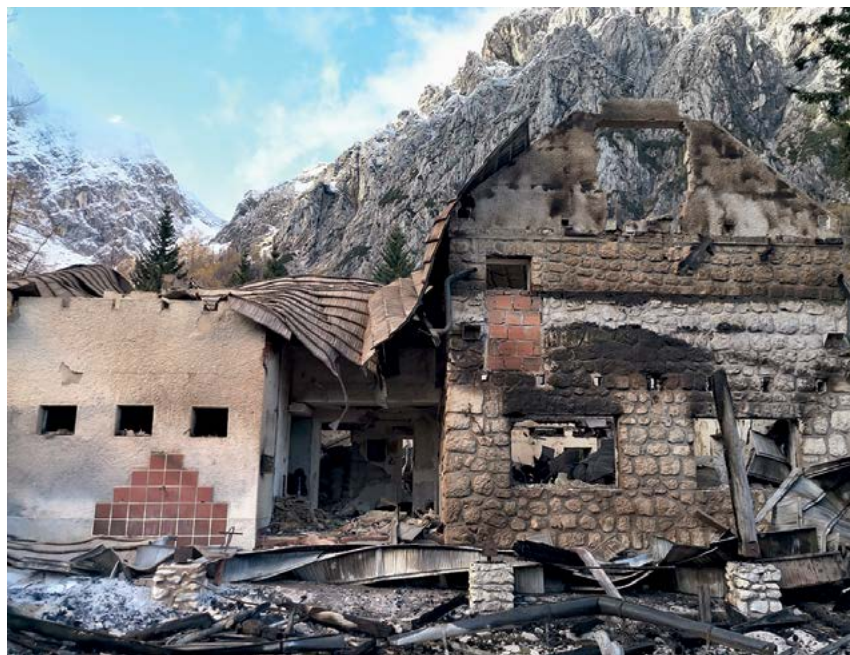
Frischaufov dom na Okrešlju je pogorel novembra 2019 zaradi napake na električni napeljavi. Foto Rock Ošep
